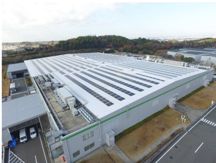
太陽光発電システムが設置された和泉工場
